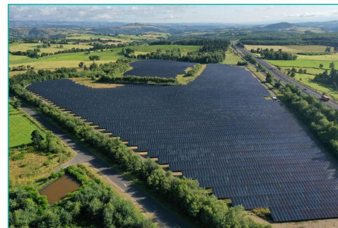
Centrale photovoltaïque de Saint-Mary-le-Plain © Hautes Terres Communauté
