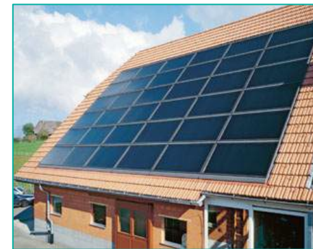
Panneaux photovoltaïques intégrés Batirama ©
